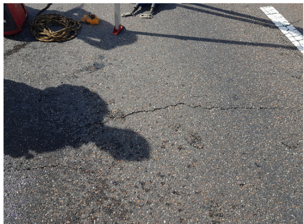
내용 포장부 아스콘균열
