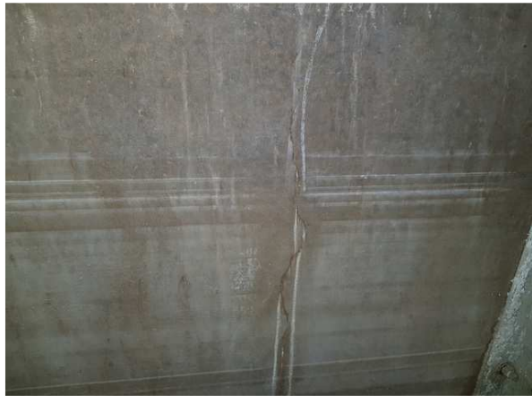
내용 벽체 균열부백태
