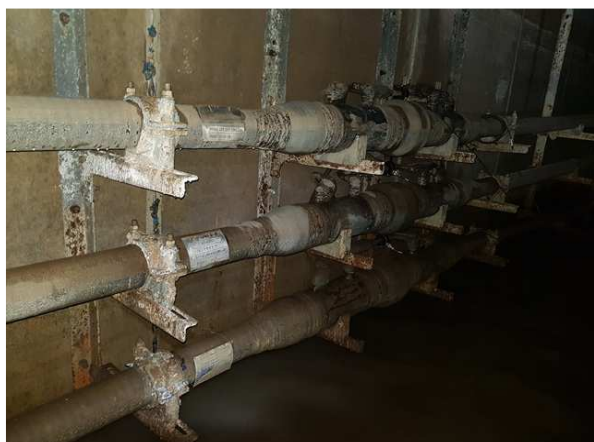
내용 받침대 상태양호
