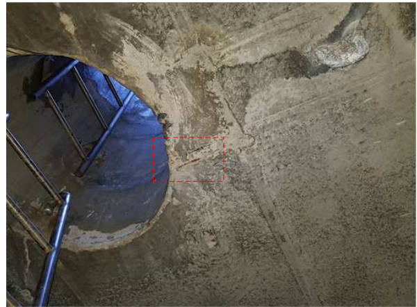
내용 상부슬래브 철근노출
