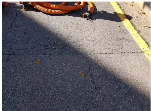
내용 포장부 아스콘균열
